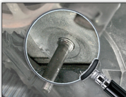
Image 1 : le goujon fileté n'est pas correctement vissé.
